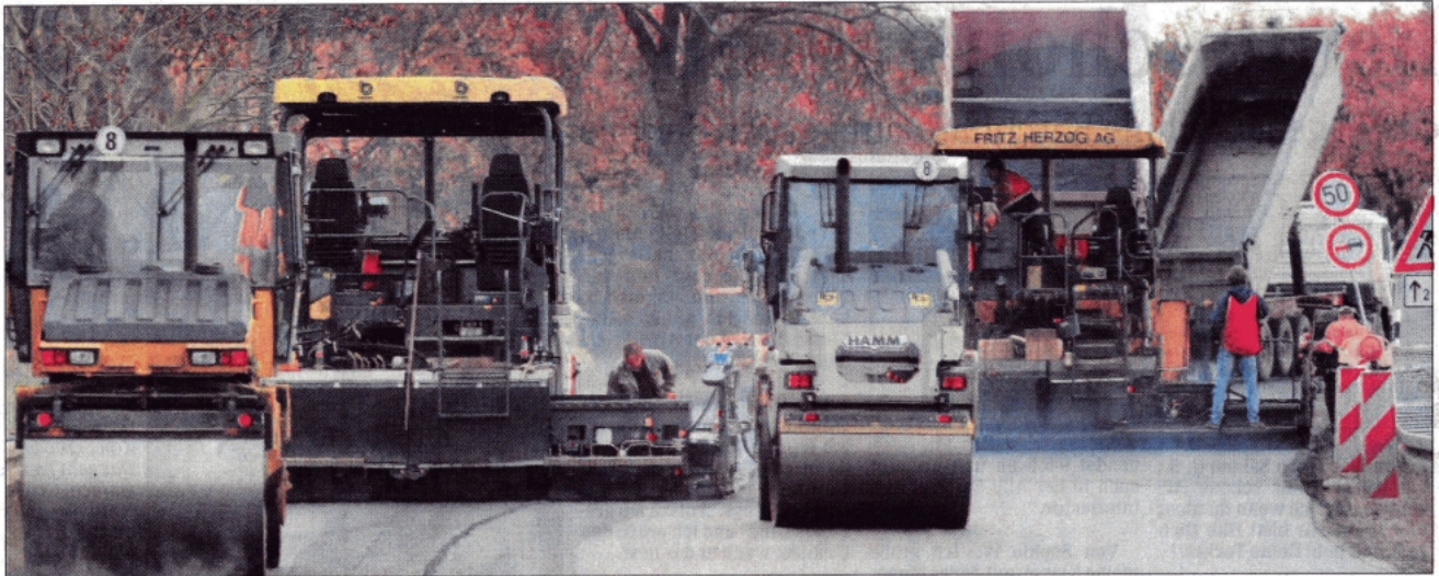
Hochbetrieb auf der Bundesstraße: Zwei Walzen, zwei Fertiger und zwei Liefer-Lkw müssen auf engem Raum rangieren können.
